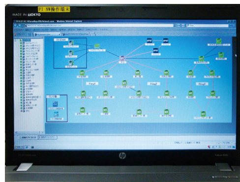
▲ Swim Managerにより、沿線全体のネットワーク管理/監視を行っている
