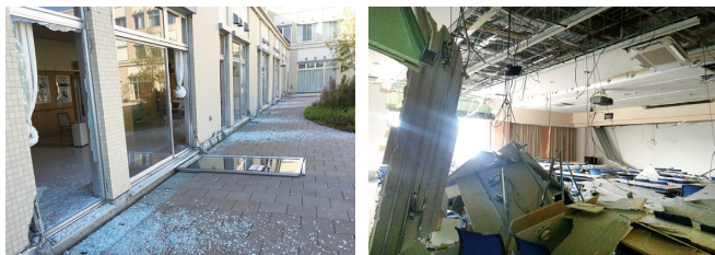
2016年4月に発生した熊本地震発生後の病院の状況。
