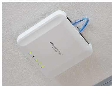
▲無線LANが構築されたことで、今後PC以外の端末の活用が進む。 無線LANアクセスポイント：AT-TQ4600
