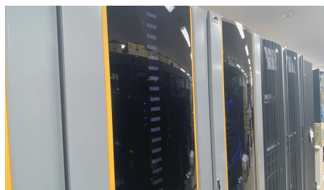
▲ サーバルーム
